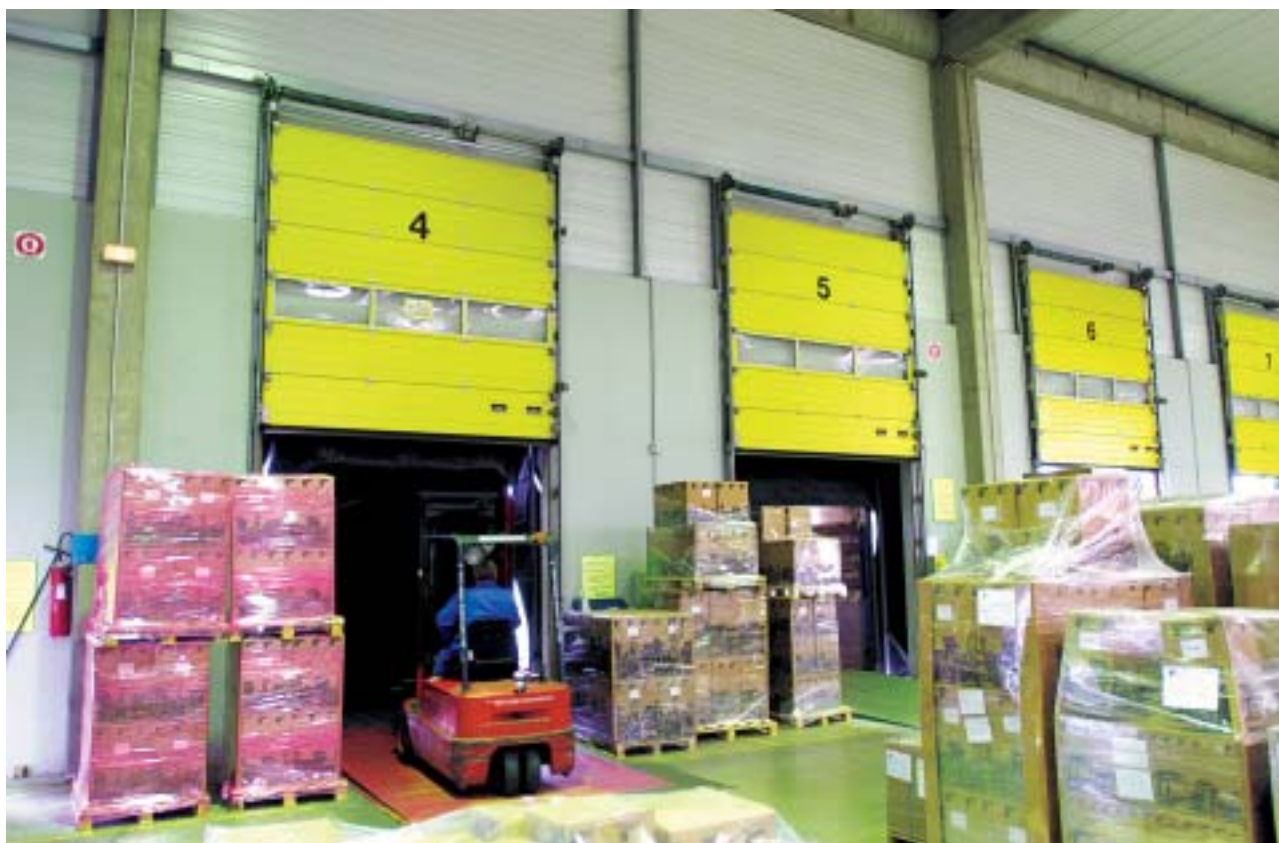
Portes sectionnelles « guillotine » et niveleur de quai.
